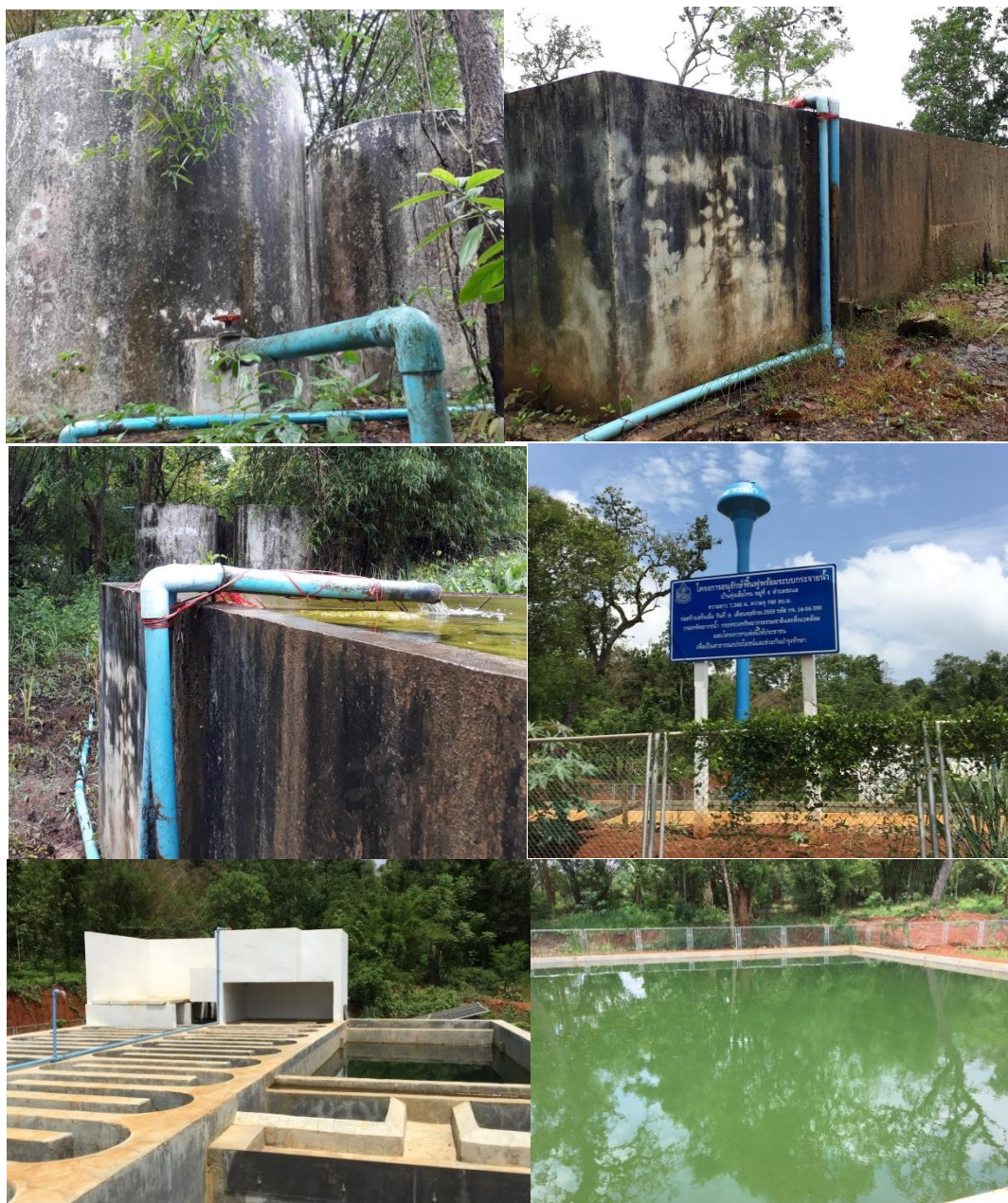
ระบบประปา
