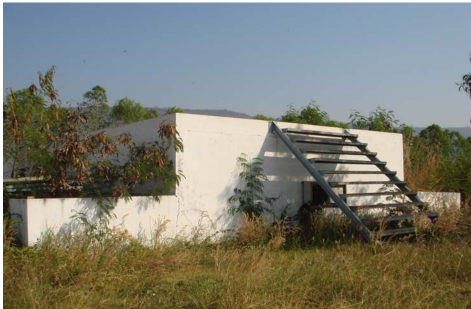
ระบบบำบัดสิ่งปลูกที่ก่อสร้างแต่ไม่มีการใช้งาน
