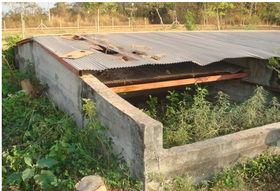
ระบบบำบัดที่มีการใช้งานแล้ว แต่ปัจจุบันไม่มีการดูแลและใช้งาน
